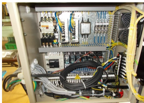
配電盤 P L C回路とリレー回路併用
